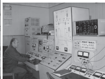
照射施設操作盤
